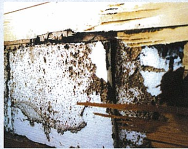
断熱材（発泡スチロール）の被害
