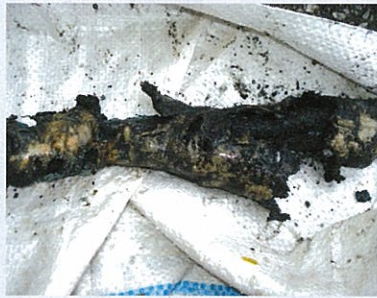
電気ケーブルの被害
